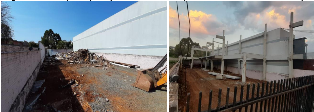
Figura 3 – Terreno para implantação da obra e estrutura pré-moldada em concreto em finalização
