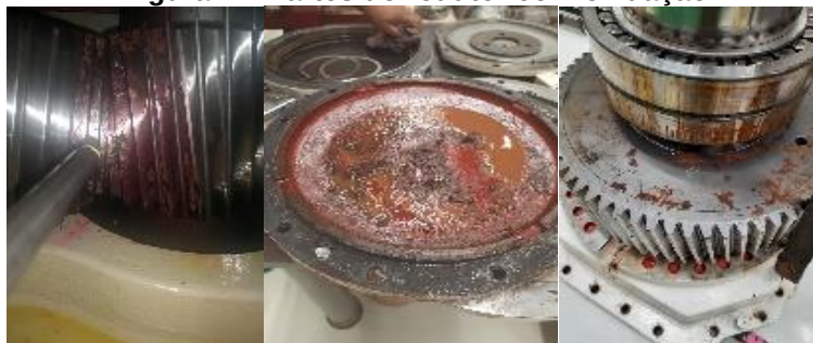
Figura 1 – Partes do redutor com oxidação
