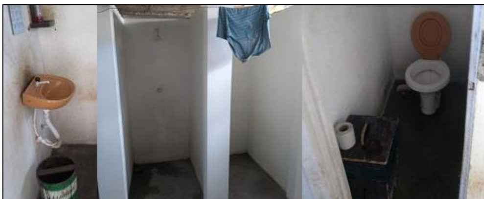
Figura 3 – Instalações Sanitárias. Fonte: autoria própria
