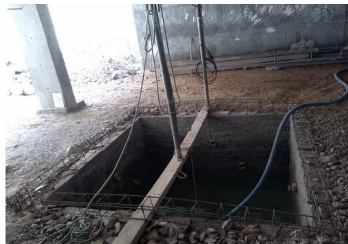
Figura 7 – Abertura do piso desprotegida. Fonte: autoria própria
