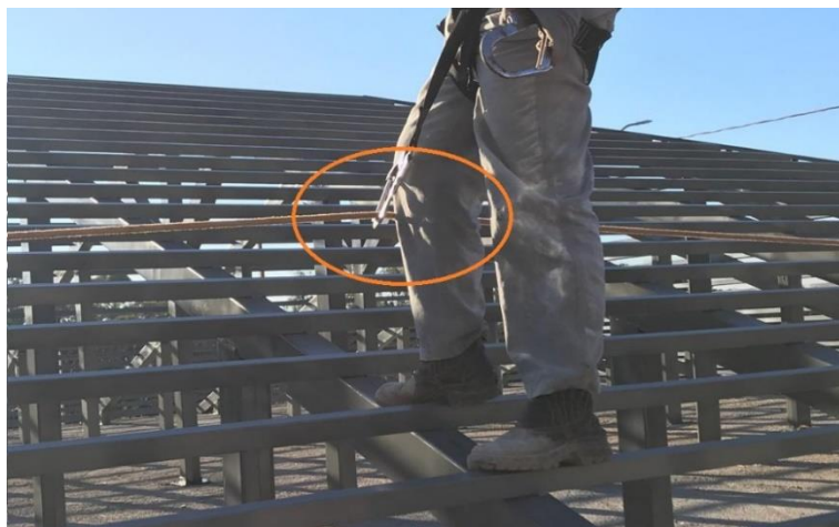
Figura 02 – Trabalhador utilizando cinto de segurança sem trava-queda Fonte: Autor (2018).
