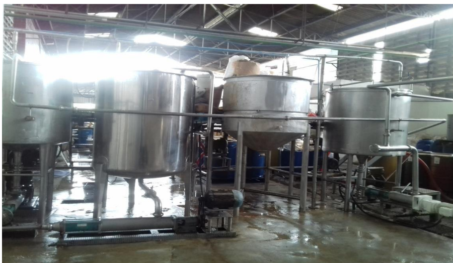
Figura 9: Tanques de preparação
