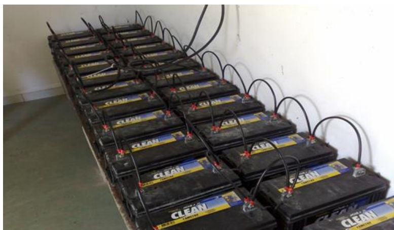
Figura 3 – Banco de baterias
