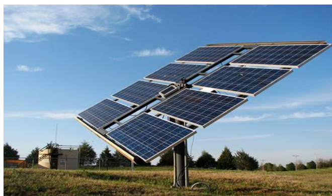
Figura 1 – Painéis de Energia Solar
