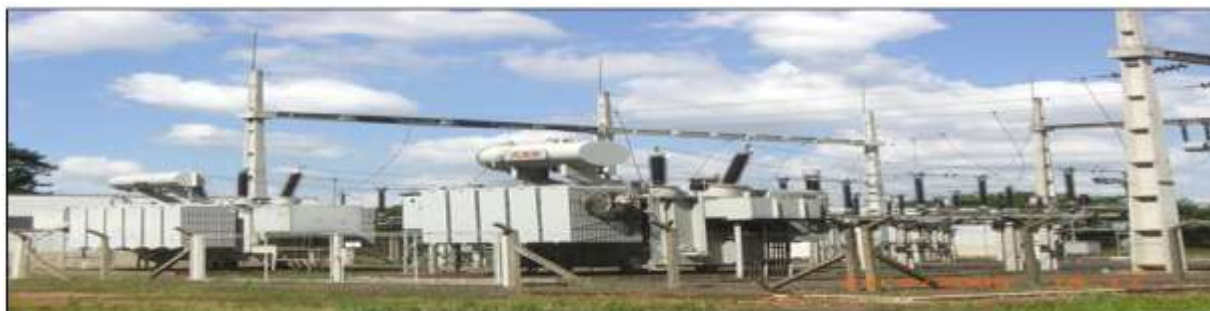
Figura 5 – Subestação de energia na usina
