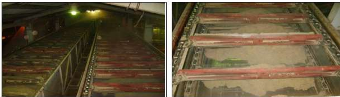
Figura 3 – Esteira metálica transportadora de bagaço
