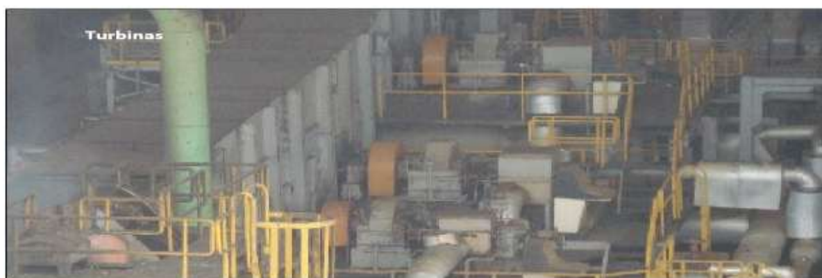
Figura 4 – Turbinas dos picadores, desfibradores e espalhadores
