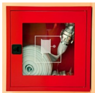
Figura 2 – Exemplo de Hidrante de Parede (NOGUEIRA, 2017)
