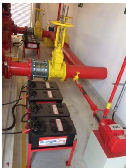
Figura 13 – Bomba Jockey e banco de baterias das bombas diesel (SANDOZ, 2017)
