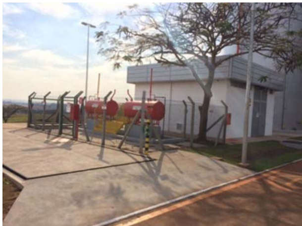
Figura 12 – Tanques de óleo diesel e casa de bombas (SANDOZ, 2017)
