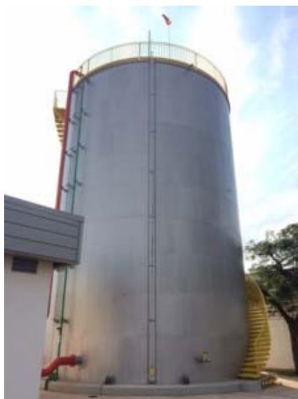
Figura 14 – Reservatório de água de combate à incêndio (SANDOZ, 2017)
