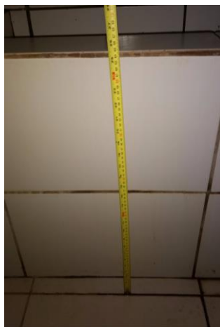
Figura 3 – Altura inadequada do mictório tipo calha
