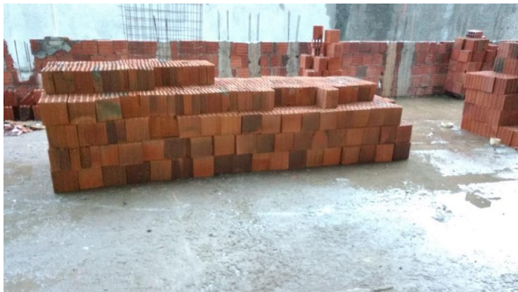
Figura 2 –Estoque inadequado de tijolos
