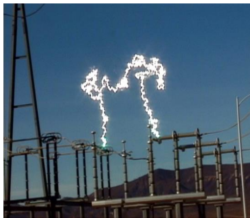
Figura 3 - Arco em subestação
