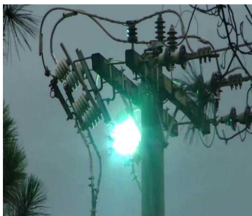
Figura 2 - Arco elétrico em rede
