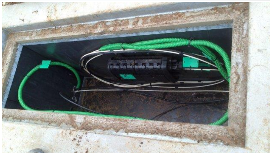
Figura 2: Caixa de passagem subterrânea Telecom Fonte: HIDROSTANK (2016).
