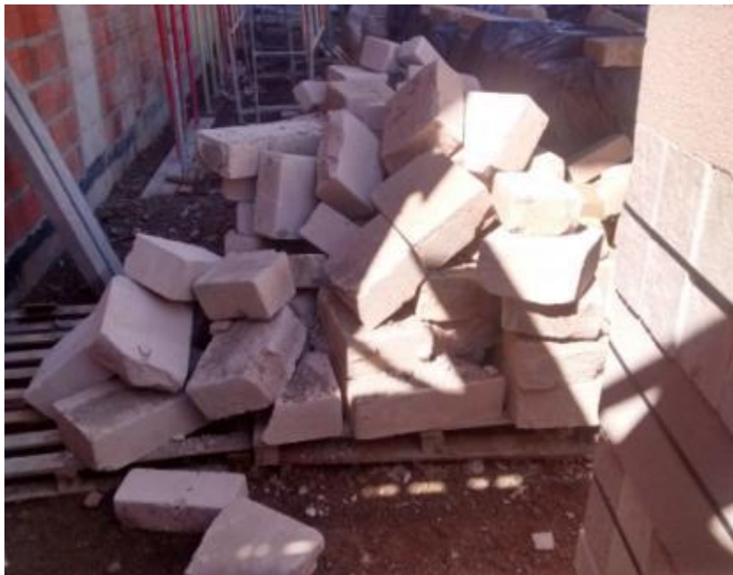
Figura 4 - Acondicionamento irregular de blocos de concreto celular Fonte: Autores
