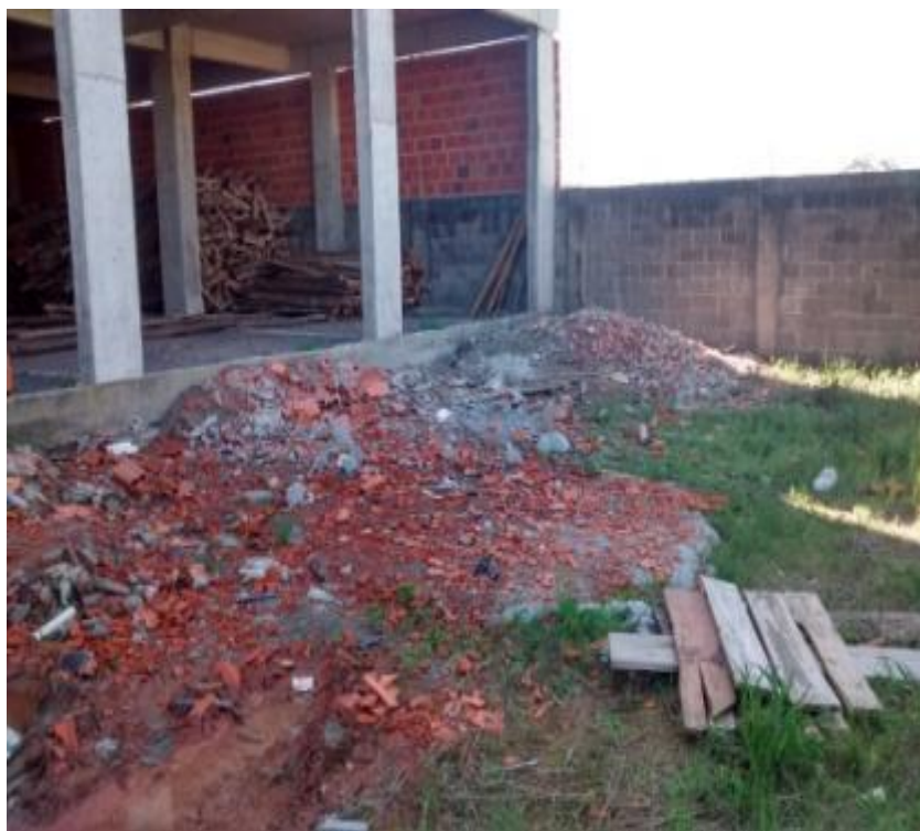
Figura 3 - Acondicionamento irregular de diversos resíduos Fonte: Autores
