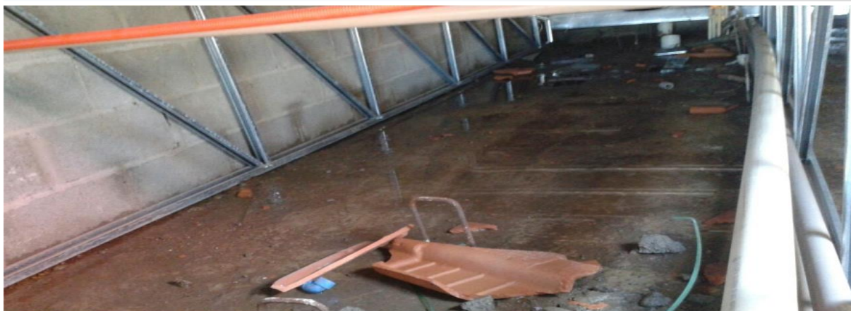
Figura 2: Alagamento no telhado devido a inclinação Fonte: autoria própria
