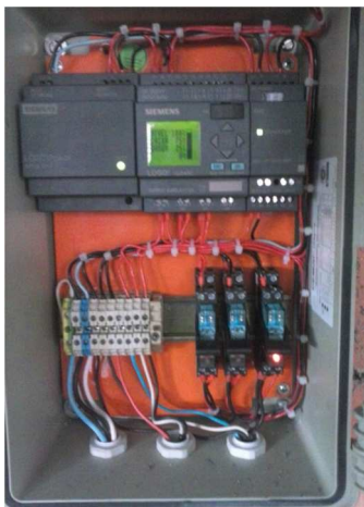
Figura 5 – Painel de Comando
