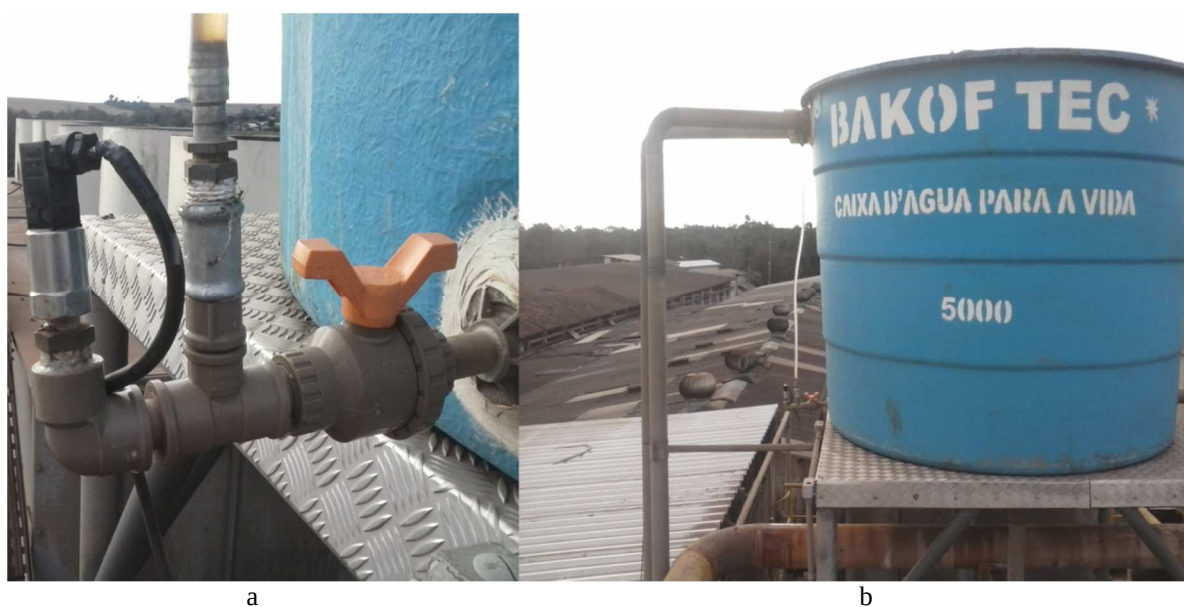
Figura 6 – Transmissor de pressão (a) e nova caixa d'água instalada (b)
