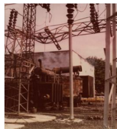
Figura 2 - Colapso das estruturas.
